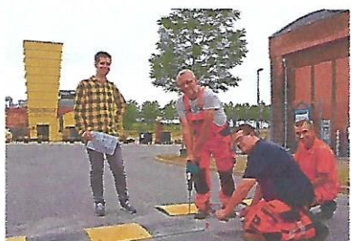
Bremsen mit Bodenschwellen Raser an der Zeche und der Bergamtsstraße aus (v.l.): Markus Wurm, Volker Putze, Andreas Bieckmann und Hermann Wenning. Foto: Stadt Ahlen
